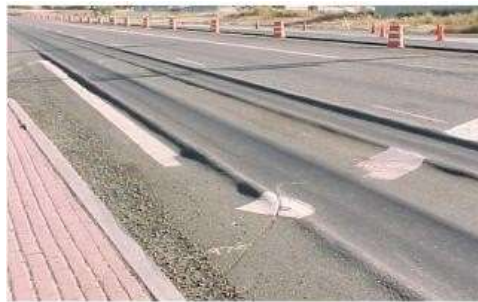
Gambar 4.12 Kerusakan tipe alur
