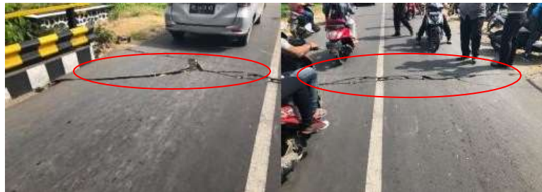
Gambar 4.20 kerusakan pada jembatan
