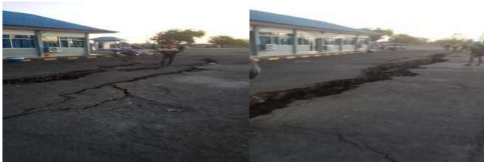
Gambar 4.22. Jalan terbelah akibat dugaan Likuifkasi di Kayangan
