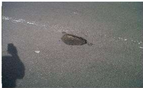
Gambar 4.14 Kerusakan tipe lubang
