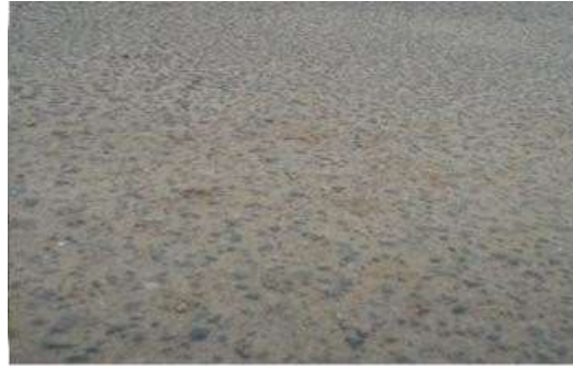
Gambar 4.5 Kerusakan tipe hungry
