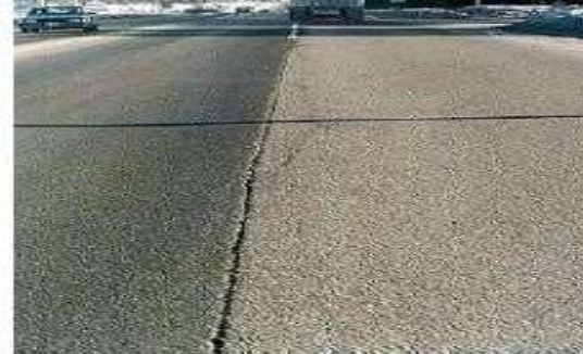
Gambar 4.11 Kerusakan tipe retak memanjang
