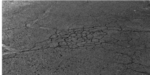
Gambar 4.8 Kerusakan tipe retak kulit buaya
