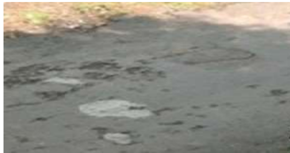
Gambar 4.4. Kerusakan tipe reveling
