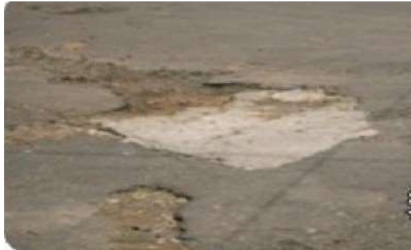
Gambar 4.3 Kerusakan tipe disintegrasi
