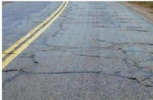
Gambar 4.9 Kerusakan tipe retak acak
