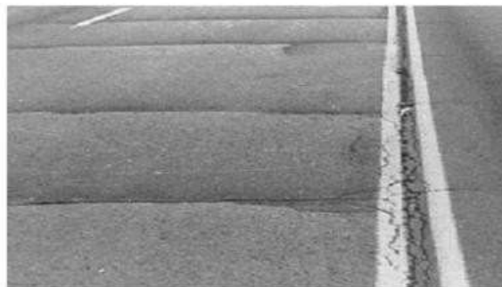
Gambar 4.10 Kerusakan tipe retak melintang
