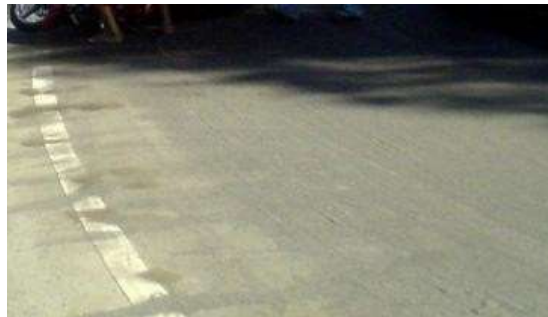
Gambar 4.7 Kerusakan tipe permukaan rapat
