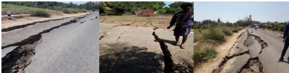
Gambar 4.21 Jalan terbelah akibat dugaan Likuifkasi di Gangga dan Kayangan
