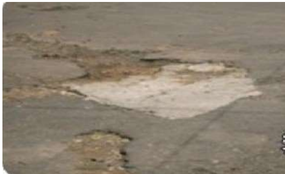
Gambar 4.3 Kerusakan tipe disiintegrasi
