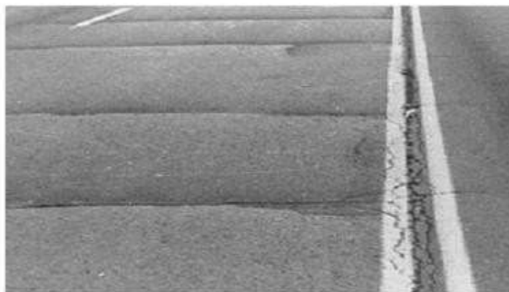
Gambar 4.10 Kerusakan tipe retak melintang
