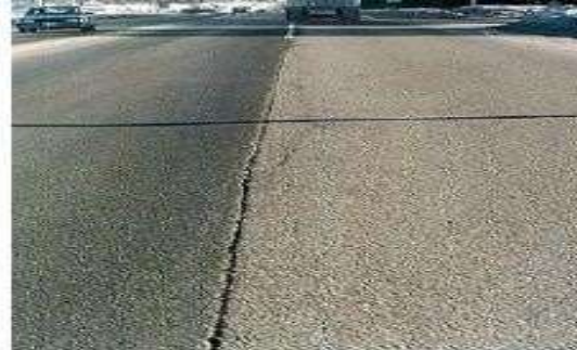
Gambar 4.11 Kerusakan tipe retak memanjang
