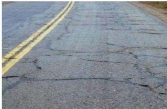
Gambar 4.9 Kerusakan tipe retak acak
