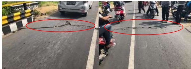
Gambar 4.20 kerusakan pada jembatan
