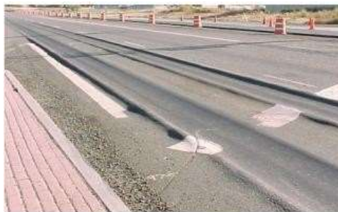
Gambar 4.12 Kerusakan tipe alur
