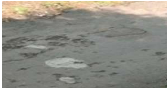
Gambar 4.4. Kerusakan tipe reveling
