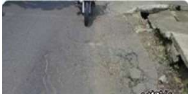
Gambar 4.13 Kerusakan tipe amblas
