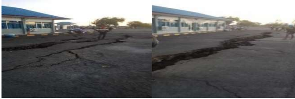
Gambar 4.22. Jalan terbelah akibat dugaan Likuifkasi di Kayangan
