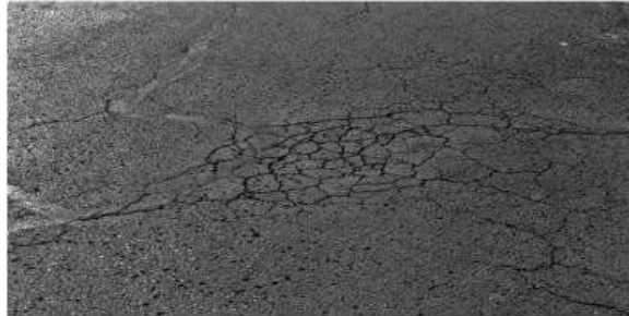
Gambar 4.8 Kerusakan tipe retak kulit buaya
